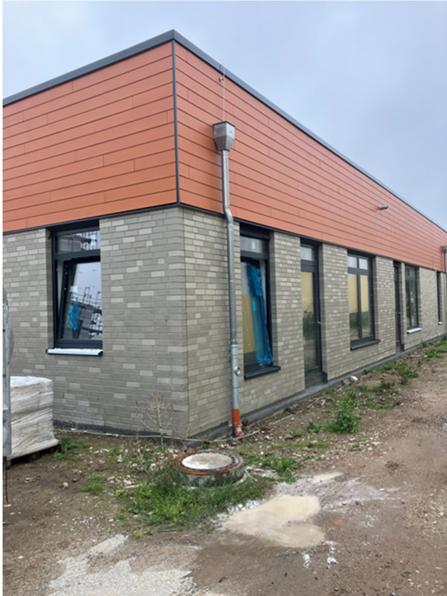
Außenansicht unserer Kita Märchenland. Im Außenbereich fehlt natürlich noch die Schicht Mutterboden.
