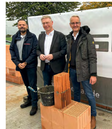
Regionalvorstand Christian Rehberg, Bürgermeister Andreas Hüffmann und Ralf Haske (Haske Bau) bei der Grundsteinlegung der neuen Kita
