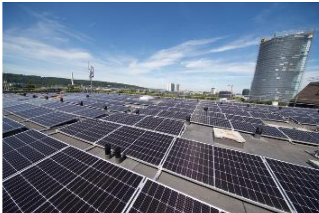
Solaranlagen auf dem Dach eines Johanniter Krankenhauses Fotoquelle: Johanniter
