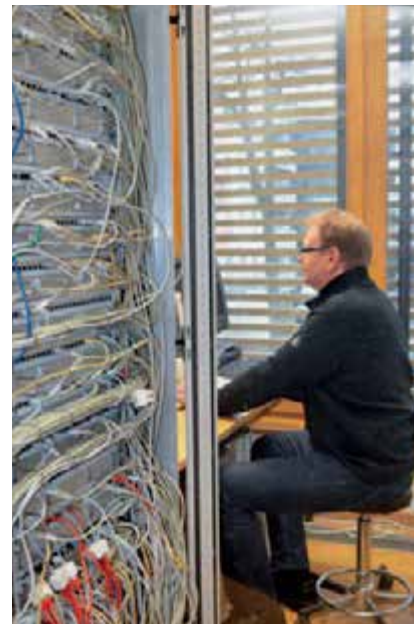
Einblick in einen JCC-Serverraum. Foto: Regina Villavicencio
